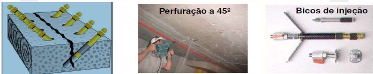
Figura 176 - Detalhes da Instalação dos bicos de perfuração para injeção de resinas de poliuretano.
