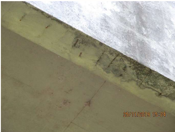
Figura 138 – Viga com corrosão
