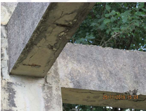
Figura 139 – Viga com corrosão
