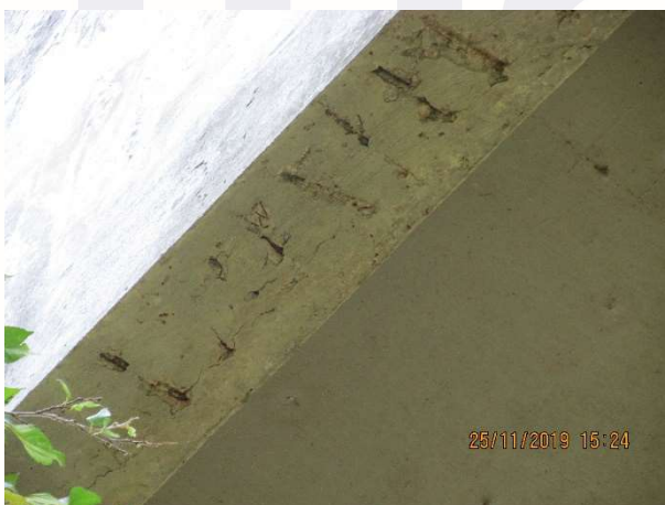
Figura 136 – Viga com corrosão
